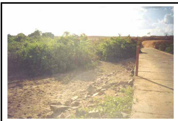
FOTO 03 – TRAVESSIA DO RIACHO DO SANGUE VISTA DO LADO DIREITO NO SENTIDO BETÂNIA – DEP. IRAPUAN PINHEIRO
