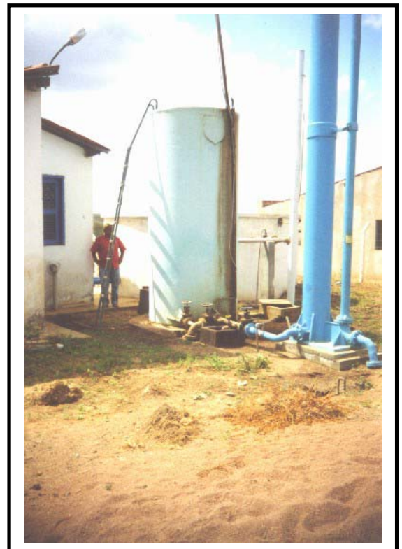
FOTO 04 – ETA EXISTENTE EM BETÂNIA COM RESERVATÓRIO APOIADO, FILTRO E CASA DE QUÍMICA
