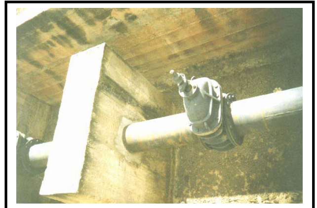
FOTO 06 – PONTO DE DERIVAÇÃO PARA A CAPTAÇÃO NA TOMADA D'ÁGUA
