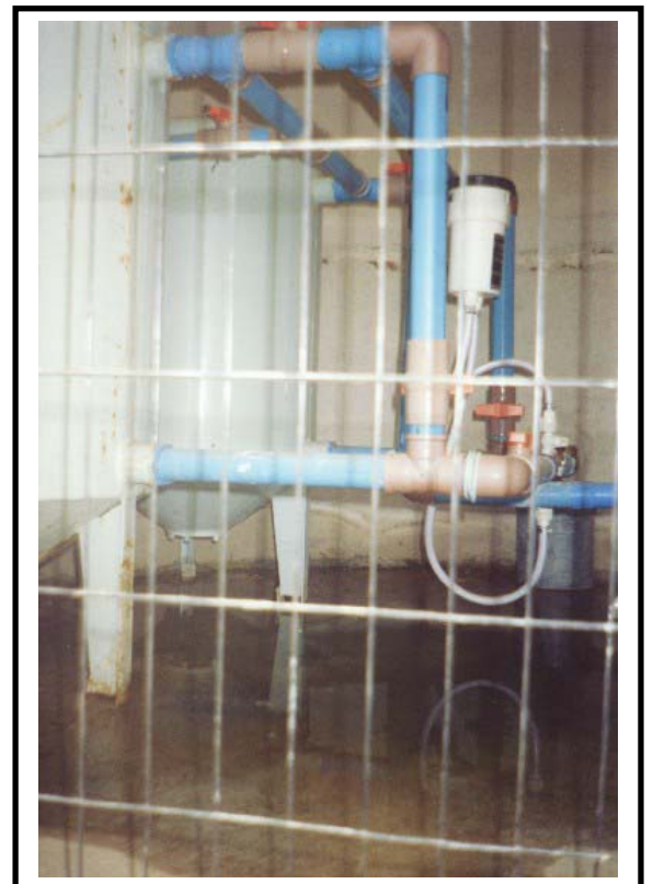
FOTO 16 – DETALHE DO SISTEMA DE TRATAMENTO DO ABASTECIMENTO D'ÁGUA DO VELAME.
